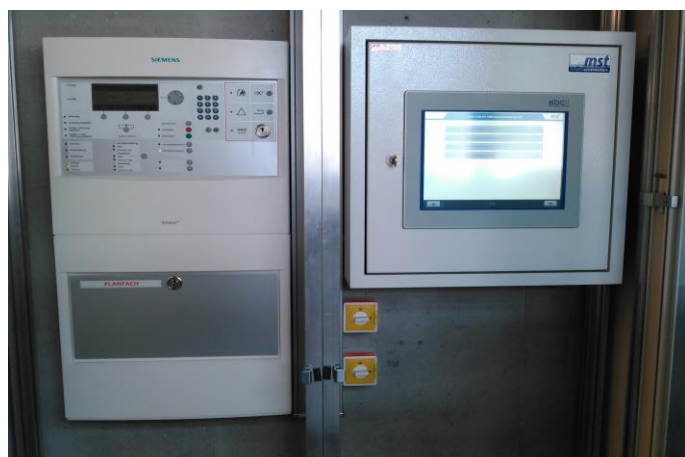
Fernsignaltafel Brandmeldeanlage und Lüftungsrückstelltafel
