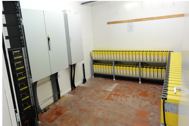
USV-Anlage 180kVA: Wechselrichter, Hand-Bypass, Batterien
