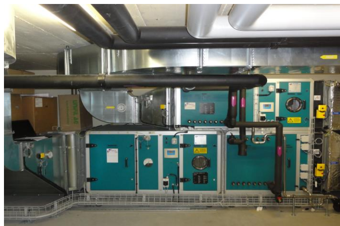
Lüftungsanlage Pneumo Gastro
