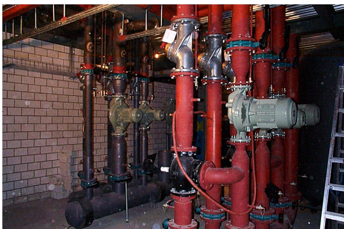
Kalt- und Kühlwasserverteiler
