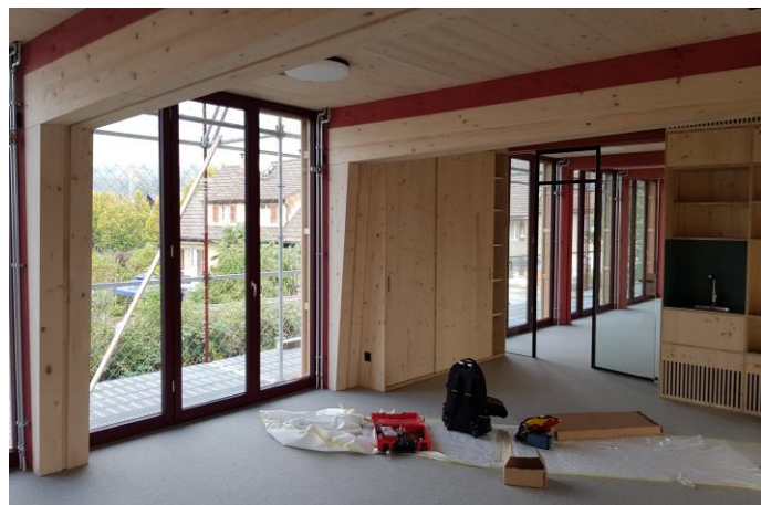
Die Leitungen Heizung und Elektro sind aufputz geführt
