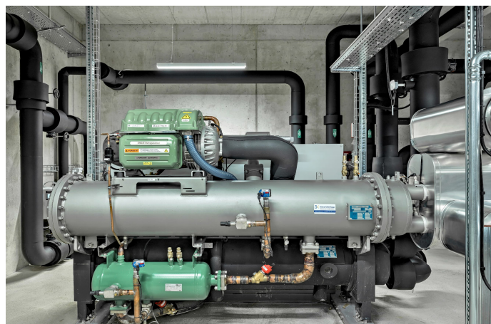
Reversible Wärmepumpe mit Grundwasser; © R. Dürr, Zürich
