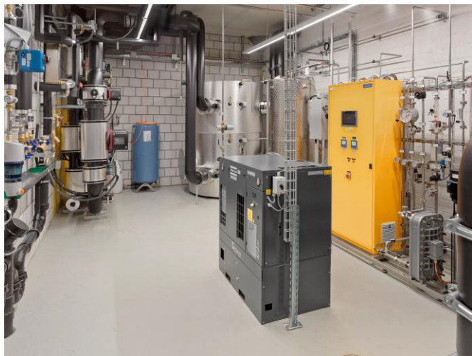
Technikzentrale Kälte und Sanitär
